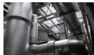
プラント配管
