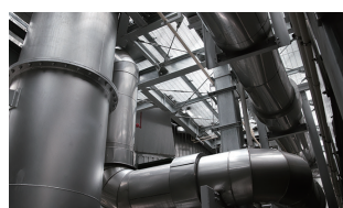
プラント配管
