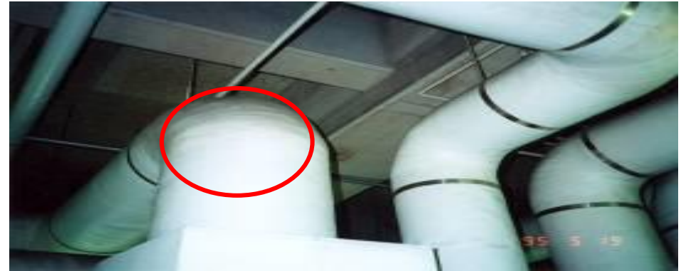
保温材(配管エルボ部等)
