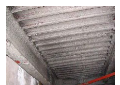
アスベスト含有吹付け ロックウール (鉄骨材の耐火被覆)
