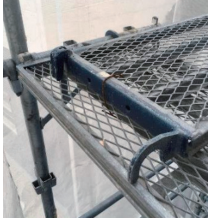
図2-16 不安定な作業床を番線で固定
