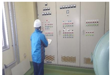
処理場中央監視室での機械点検
