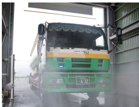
車両消毒設備
