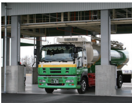
バラ製品タンク出荷設備
