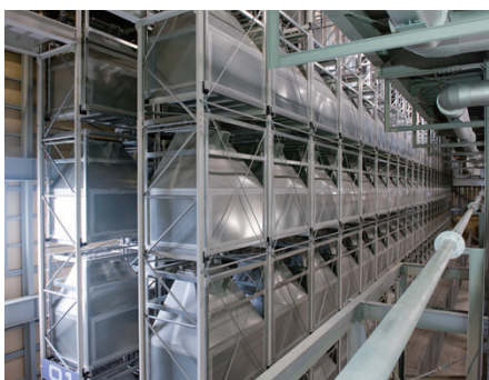
小口出荷設備
