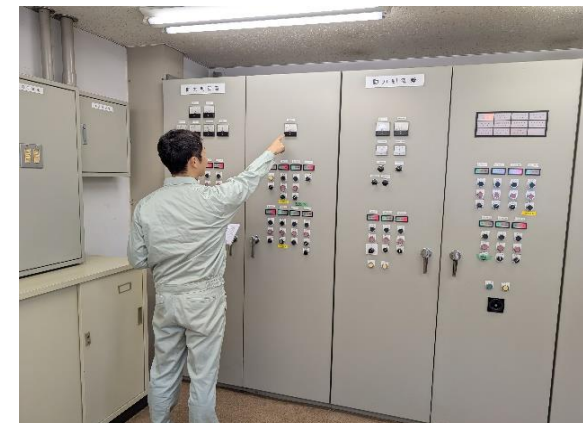
制御盤チェック風景
