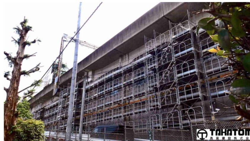
鉄道関連工事の様子です。 駅舎以外のインフラ整備なども行っています。
