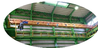
床上操作式クレーン
