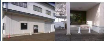
② 屋根の直下に柵を設け立ち入り禁止とした。
