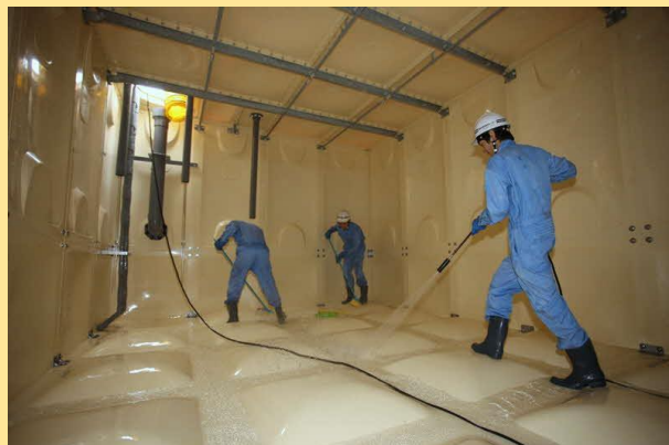
【貯水槽メンテナンス】
