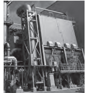
バグフィルタ外観
