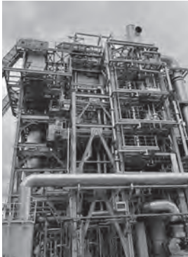
ボイラエリア
