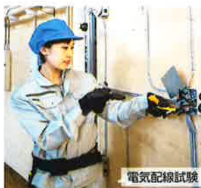
ケーブル配線基礎
