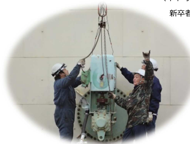
電気計装設備のメンテナンス、電動モーターの修理をしています！
