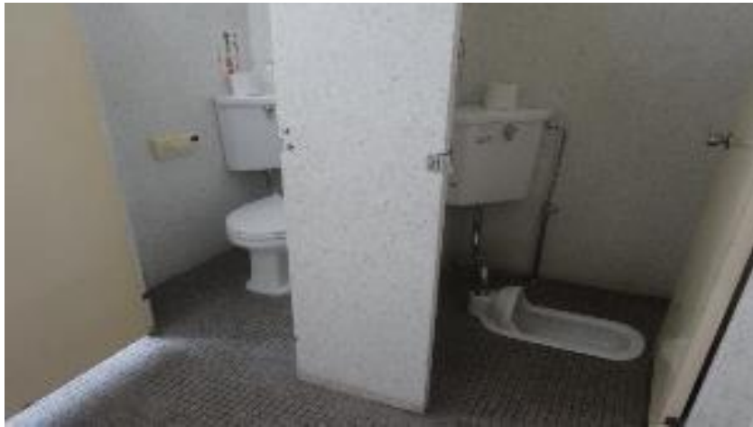
2階女性用便所（計2台）
