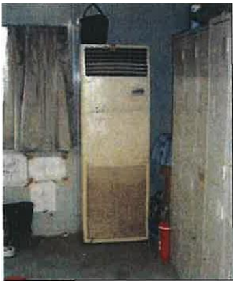
写真 3：休憩所に設置したエアコン
