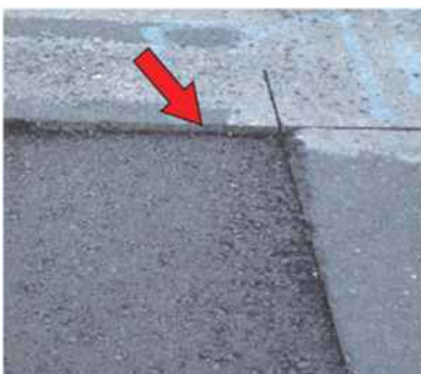
既設舗装と仮舗装の段差
