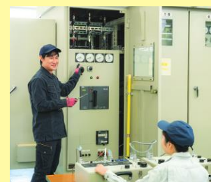
▲受変電設備点検
