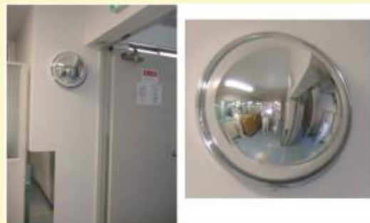
階段と廊下の交差部にカーブミラーを設置して、出会い頭の接触を防止している。
