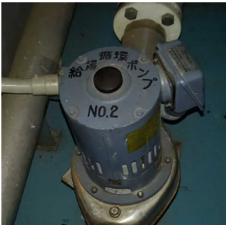
循環ポンプNo.2
