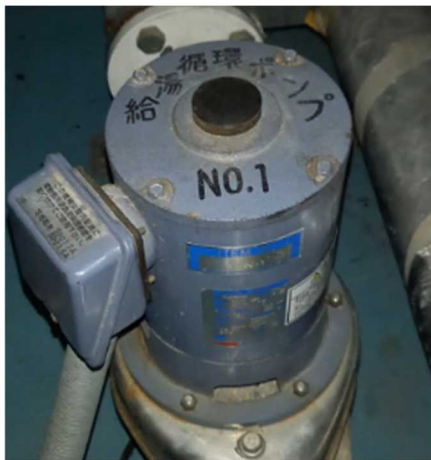
循環ポンプNo.1
