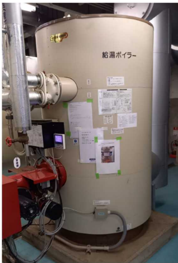
給湯ボイラー バグティンヒーター
