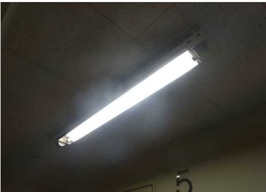
千葉公共職業安定所 利用者用階段 照明器具
