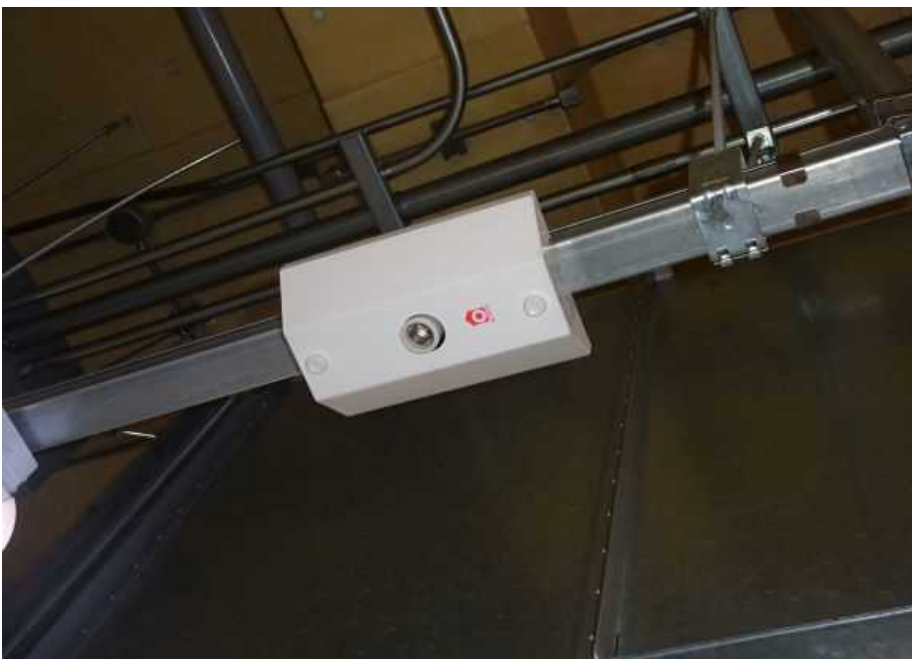
千葉公共職業安定所 5階機械室 非常用照明器具
