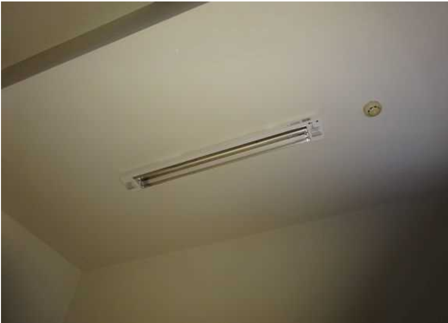
千葉公共職業安定所 利用者用階段 照明器具
