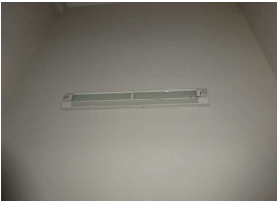
千葉公共職業安定所 職員用階段 照明器具
