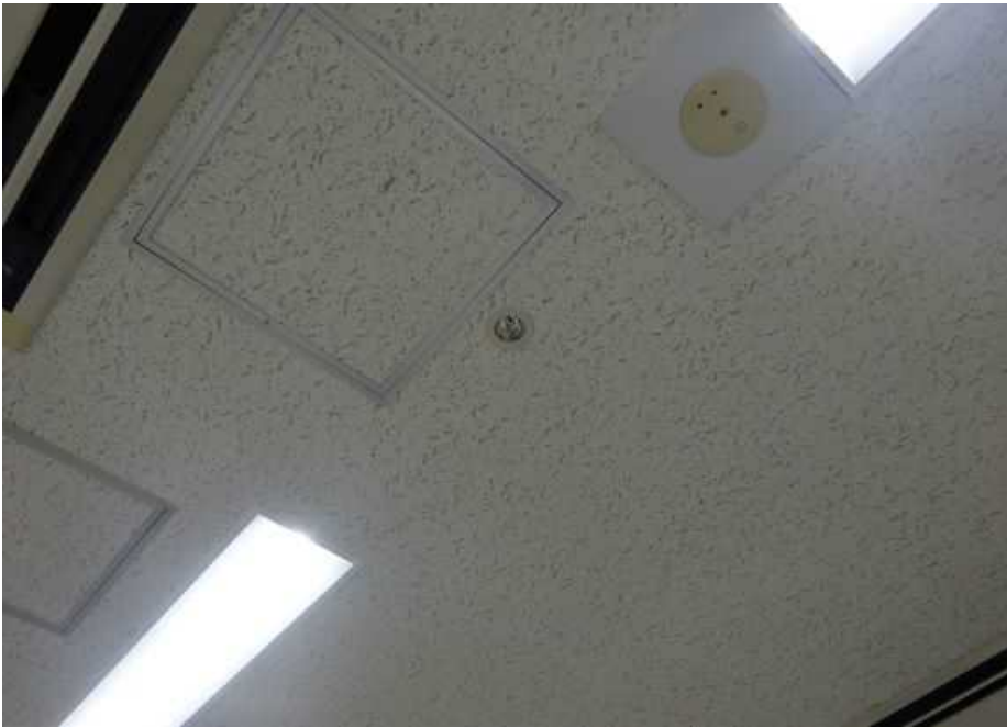
千葉公共職業安定所 4階会議室 非常用照明器具
