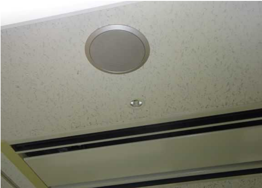
千葉公共職業安定所 5階会議室 非常用照明器具
