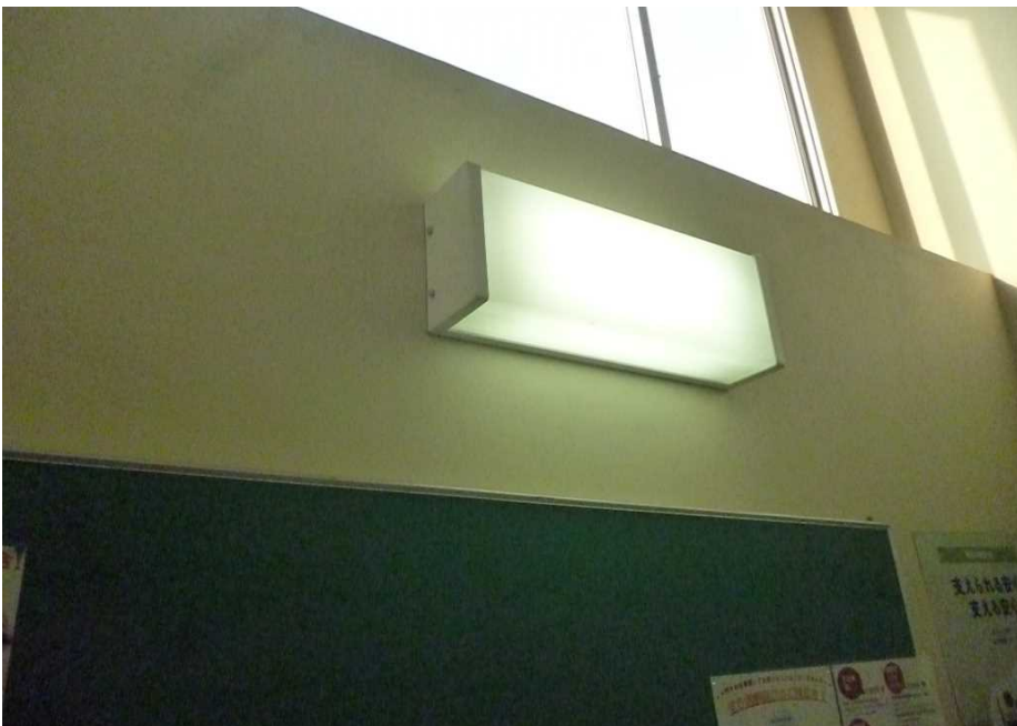
館山公共職業安定所 平面図⑮の蛍光灯
