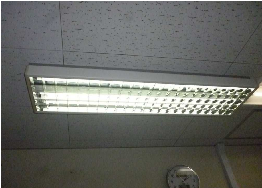
館山公共職業安定所 平面図⑭の蛍光灯
