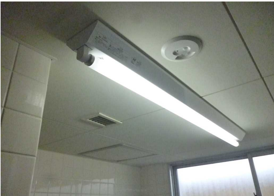
館山公共職業安定所 平面図⑪の蛍光灯
