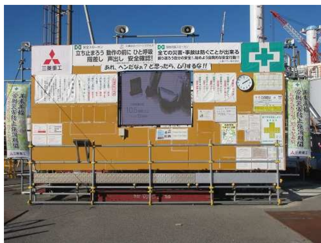
↑ 朝礼台と朝礼台に設けられたモニター
