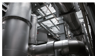
プラント配管
