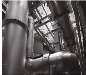
プラント配管
