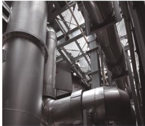
プラント配管
