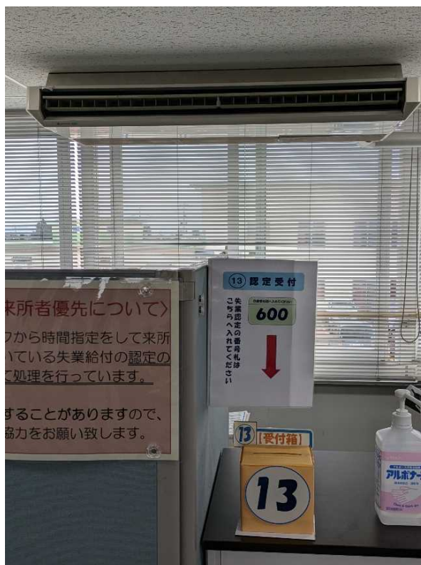
2F待合席(給付側)兼事務室エアコン
