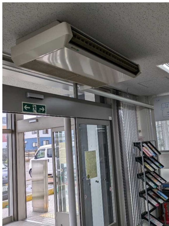
1F 窓口(紹介部門)兼事務室エアコン
