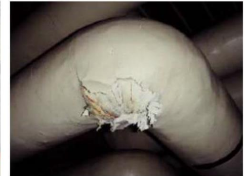
石綿含有保温材(配管エルボの保温材)
