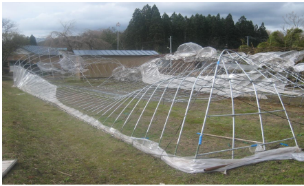
台風によるハウスの被害
