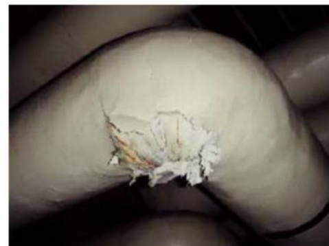
石綿含有保温材（配管エルボの保温材）
