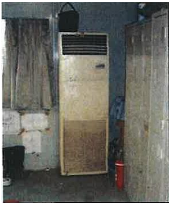
写真 3 : 休憩所に設置したエアコン
