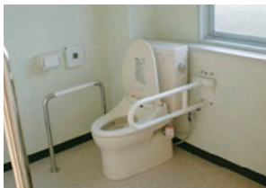
車いす用トイレ
