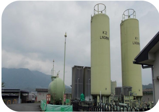
ガスの貯槽タンク(後ろには金剛山)
