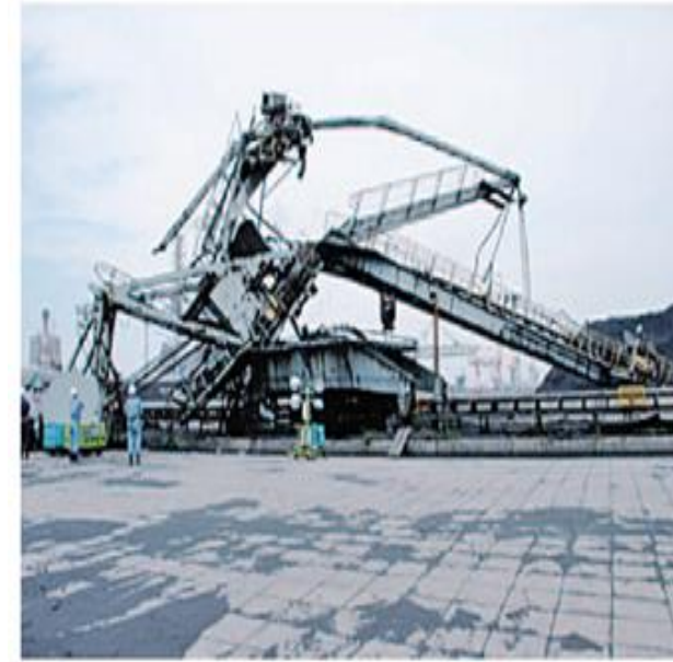
クレーンの崩落災害
