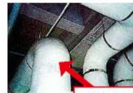
配管の保温用
