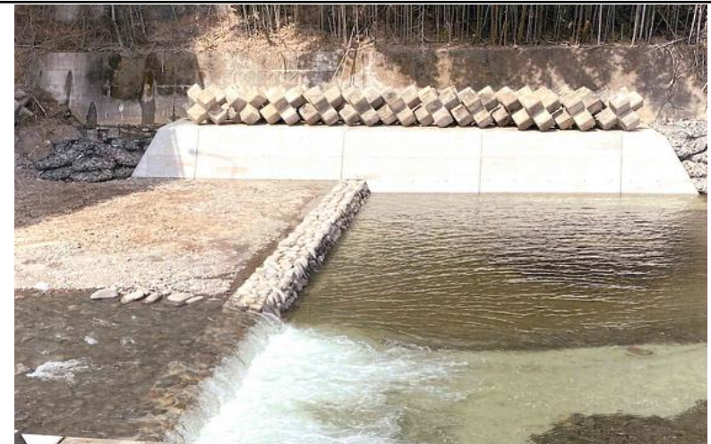
【河川防災工事（県発注）】 河床低下は、橋や護岸等に大きな影響を与えています。この工事は、河床低下を止めるための床止工として施工しました。
